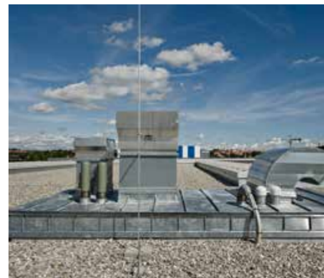
Dachaufbau lose verlegt mit Auflast
