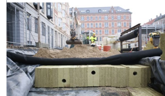
La foto sotto mostra come è stato installato Rockflow sotto la superficie della piazza. A differenza dell'isolamento, la lana di roccia del sistema Rockflow è appositamente progettata per assorbire e trattenere l'acqua. Un sistema di tubi e pozzetti porta l'acqua piovana al tampone di lana di roccia dove viene assorbita rapidamente e rilasciata lentamente, nella rete fognaria o nel terreno circostante.
